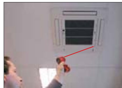
Измерение эффективности рассеяния тепла в воздуховодах для обнаружения и определения местоположения тепловых потерь в системе воздуховодов.
